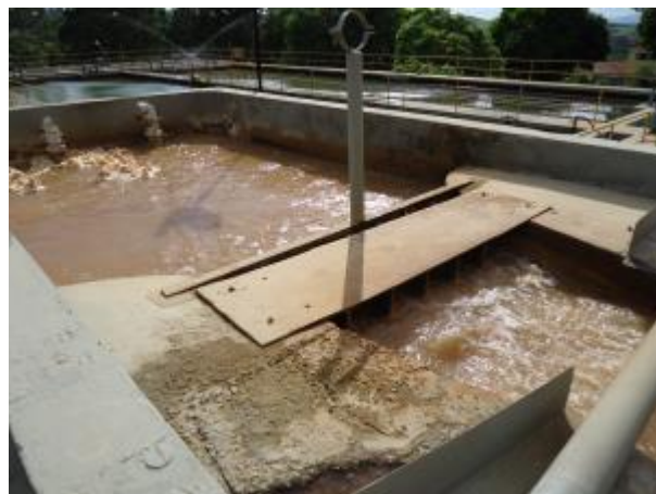
Foto 4.4 – Caixa de entrada na ETA.
