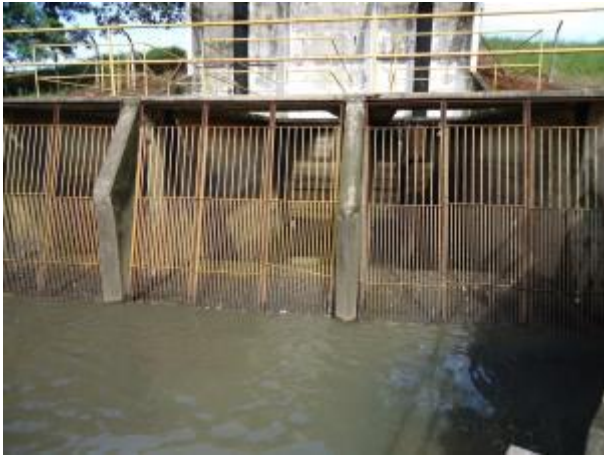
Foto 4.15 – Gradeamento da EEE Final.
