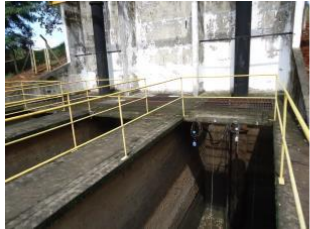
Foto 4.16 – EEE Final – Poço de sucção das bombas submersíveis.
