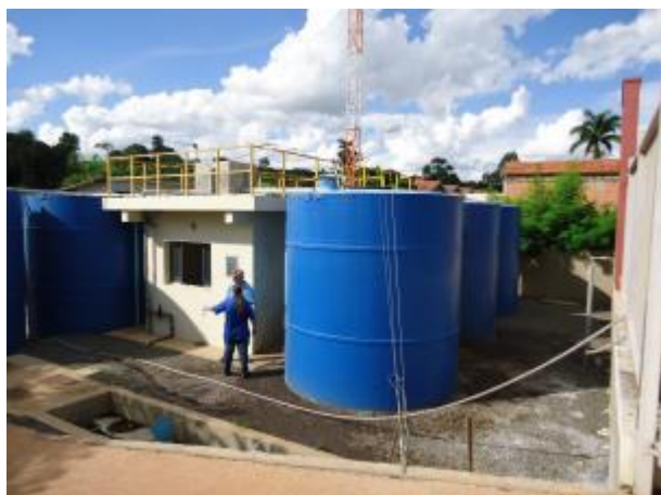
Foto 4.23 – ETE Alvorada – UASB + Aeração.
