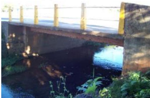
Foto 4.43 - Aspectos da sub-bacia M-E-2. (Fonte: Plano de Drenagem, 2011)
