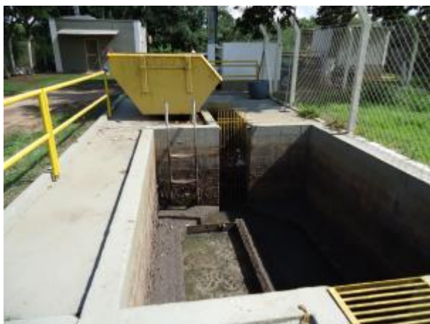
Foto 4.21 – ETE Martinho Prado Jr – Unidade de entrada.
