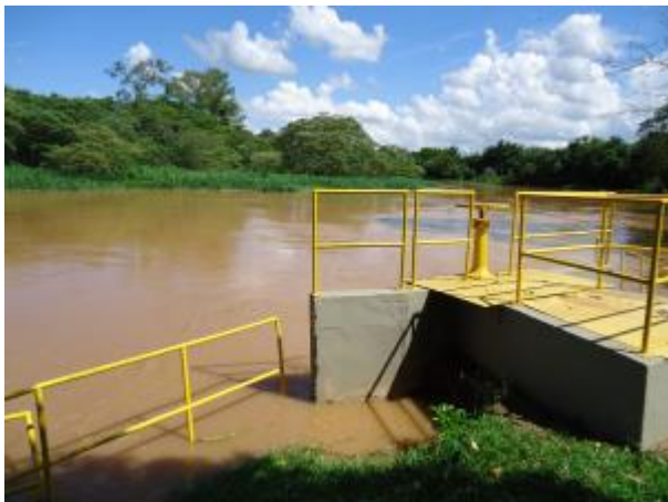
Foto 4.9 – Martinho Prado Jr - Captação no Rio Mogi Guaçu
