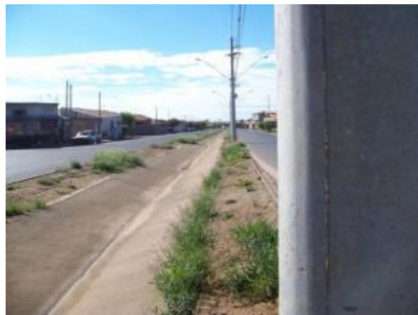
Foto 4.30 - Valeta de drenagem no canteiro central da Al. Nazareth Maria Biazotto (Fonte: Plano de Drenagem, 2011).
