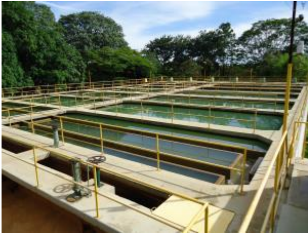
Foto 4.5 – Decantadores da ETA.
