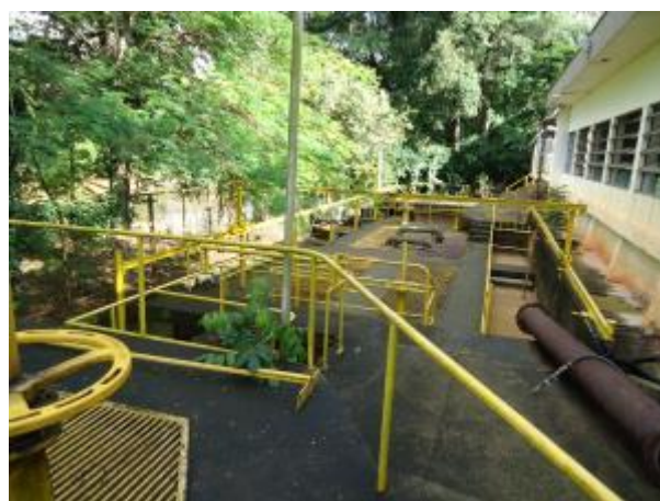
Foto 4.2 – Local da captação 2 no Rio Mogi Guaçu, junto às EEAB 1 e 2
