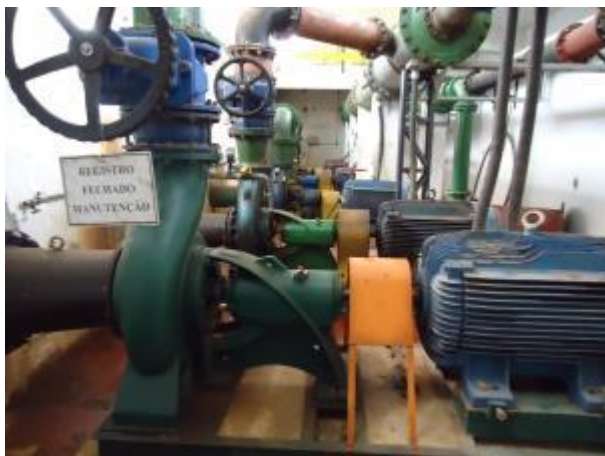
Foto 4.3 – Captação 1 – EEAB 1 e 2 – 2 conjuntos para cada adutora – Nova e Velha.
